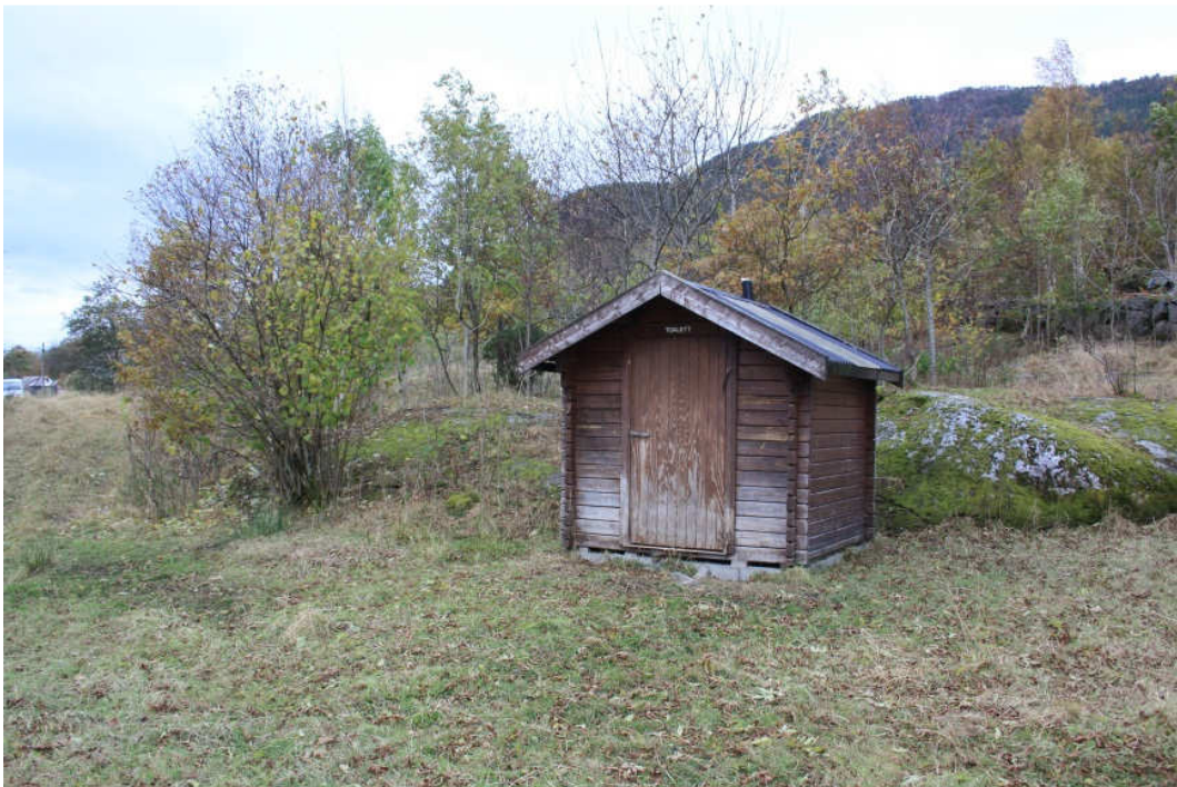
Toalettet i Kvaløy friluftsområde er modent for utskifting
