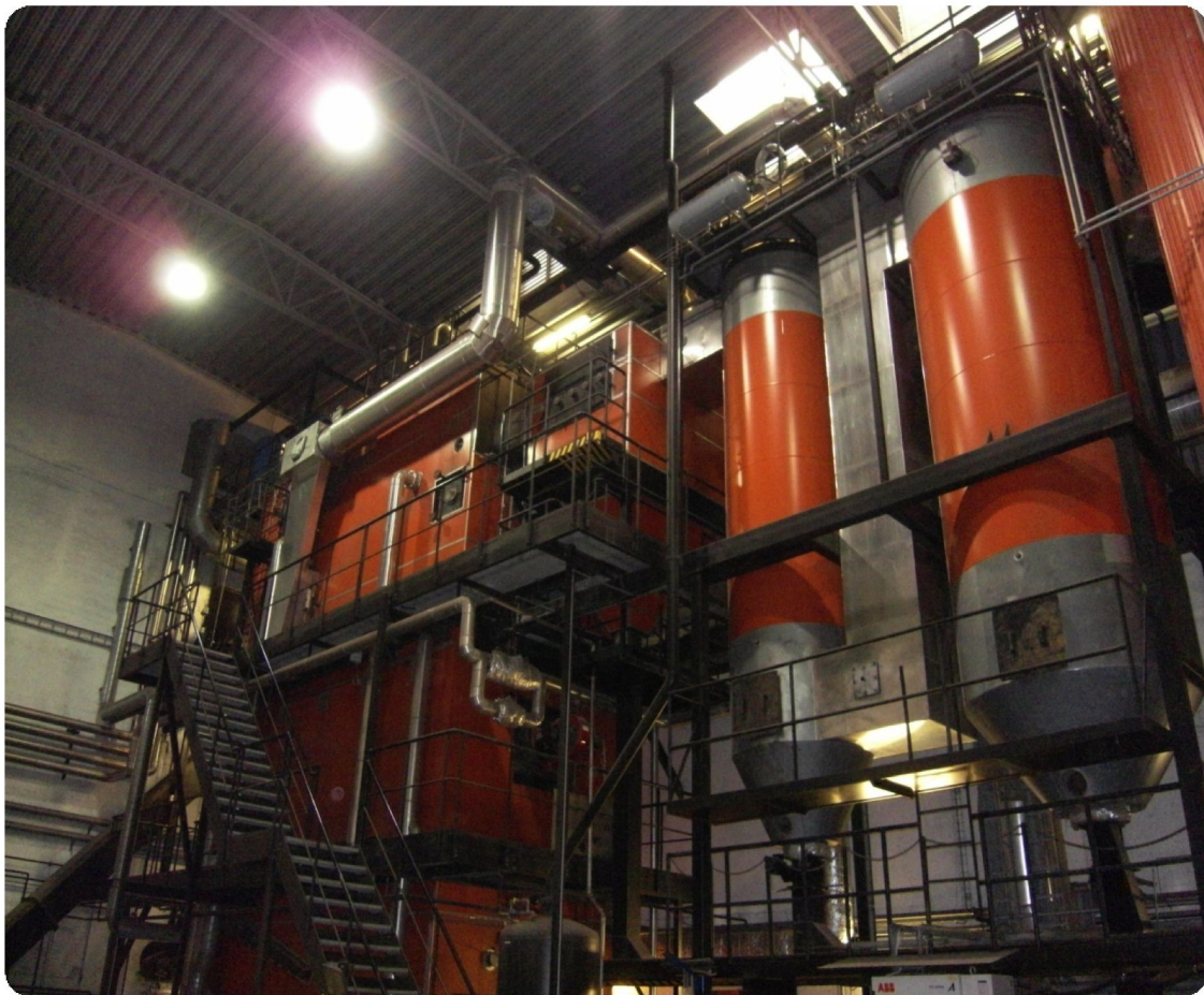
Figur 5-1: Forbrenningsanlegget. (Ovn/kjel til venstre, syklon i midten oppe og economiser til høyre.
