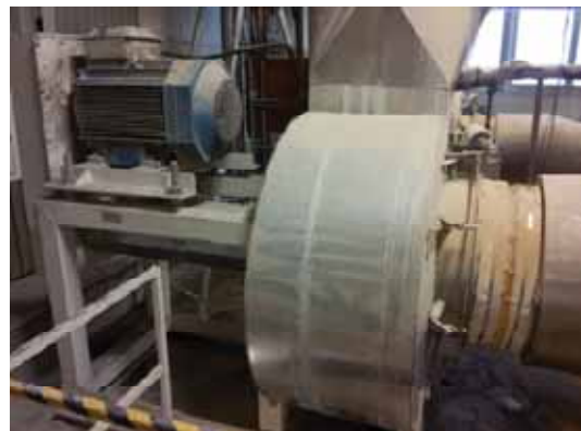
Viften er på 45 kW med reimtrekk
