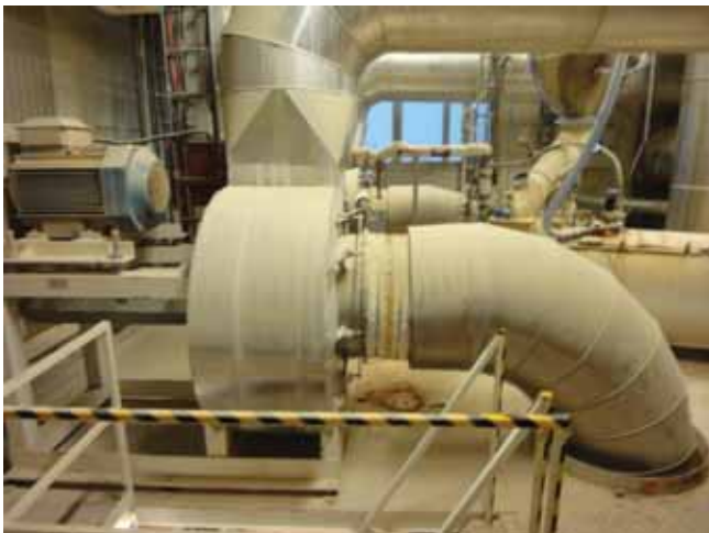
Viften suger fra syklonen og fører luften til pipe
