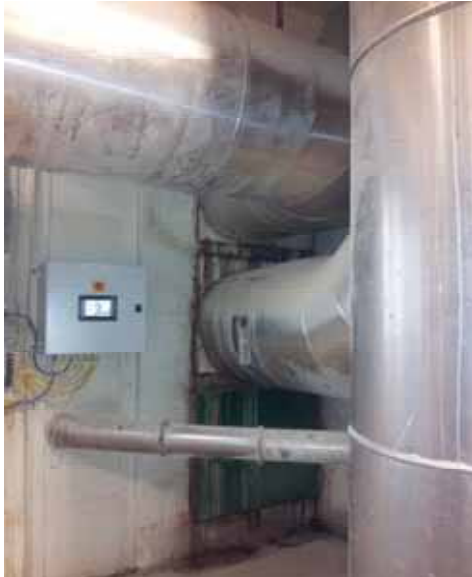
Kanaler fra vifte går ut vegg til pipe
