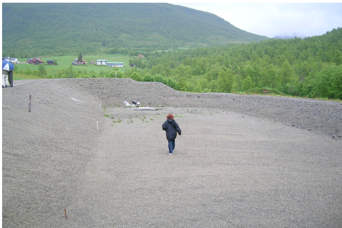
Figur 9: Åpent infiltrasjonsanlegg for slamavskilt avløpsvann ved Voss Fjellandsby, for 350 hytter og 2 hoteller. Renseanlegget er dimensjonert for 2 400 pe, og skal ferdig utbygd bestå av 5 åpne basseng. Bassenget på bildet har en bunnflate på 600 m 2 . Etter flere års drift er bassengbunn og sidevegger dekket av gras- og urtevegetasjon.
