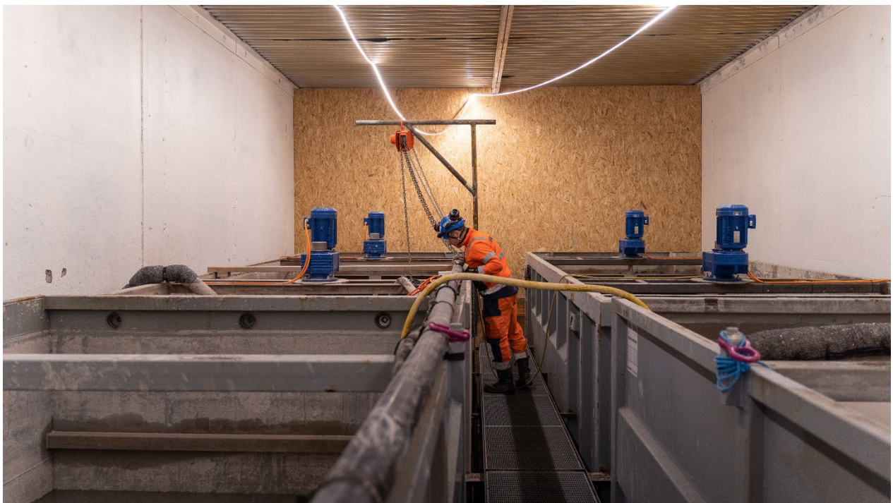
Figur 14 Bilde viser containere for mottak av tunnel slam inne i hallen der selve filterpressen er montert. De blå elektromotorene tilhører omrørere for å hindre at finstoff sedimenterer før filterpresseprosessen.
