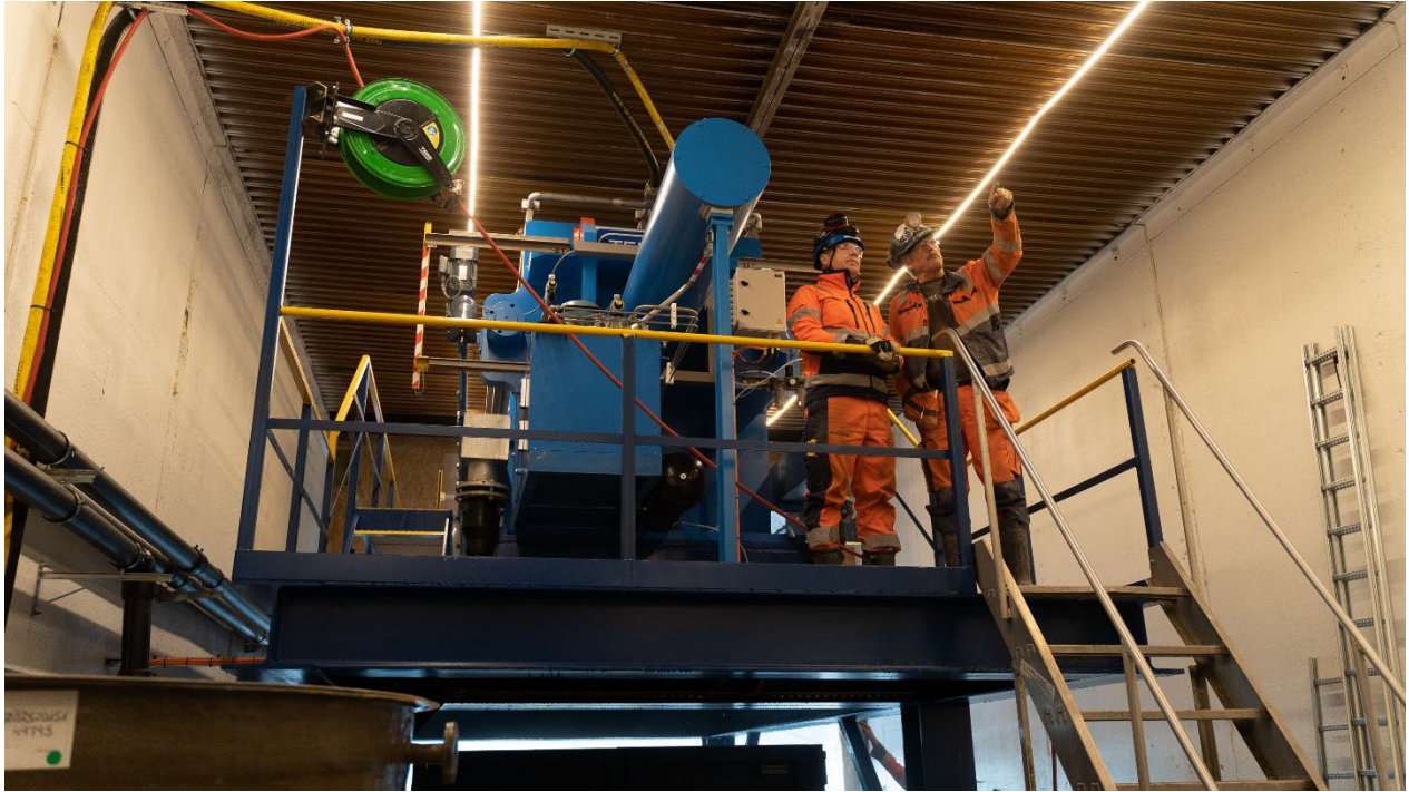
Figur 13 Bildet viser anleggets filterpresse, montert inne i den ene tørkehallen.
