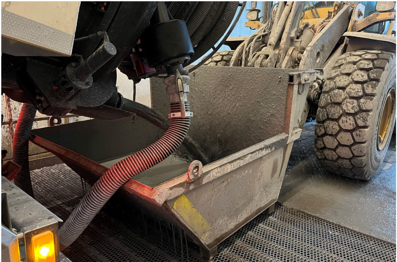
Figur 12 Bildet viser tømning av tunnel slam gjennom grovsikte (liten kontainer på hjullaster) før det går i tømmeikum tilkoblet filterpresseanlegget.
