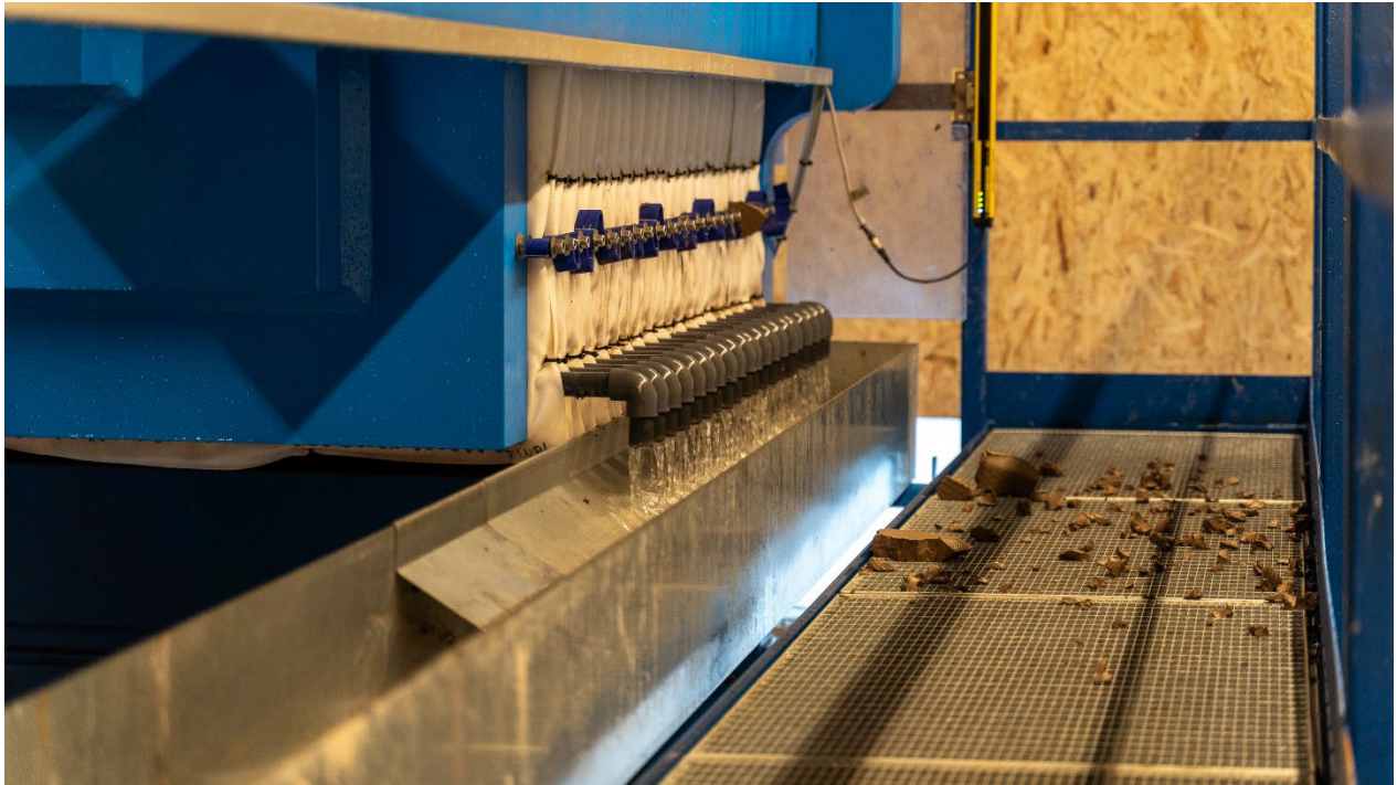
Figur 15 Bilde viser vann som presses ut fra slammet. Merk at vannet er helt klart og uten suspendert stoff.
