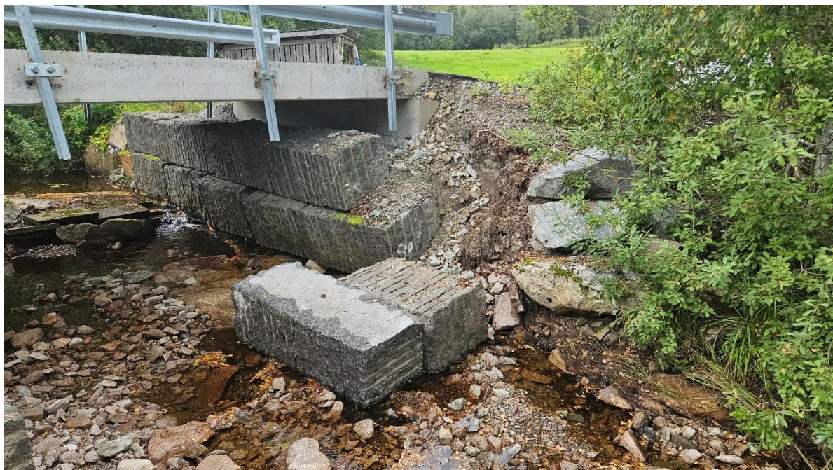
Figur 3-8. Utsklidning av brufundament i bekk.
