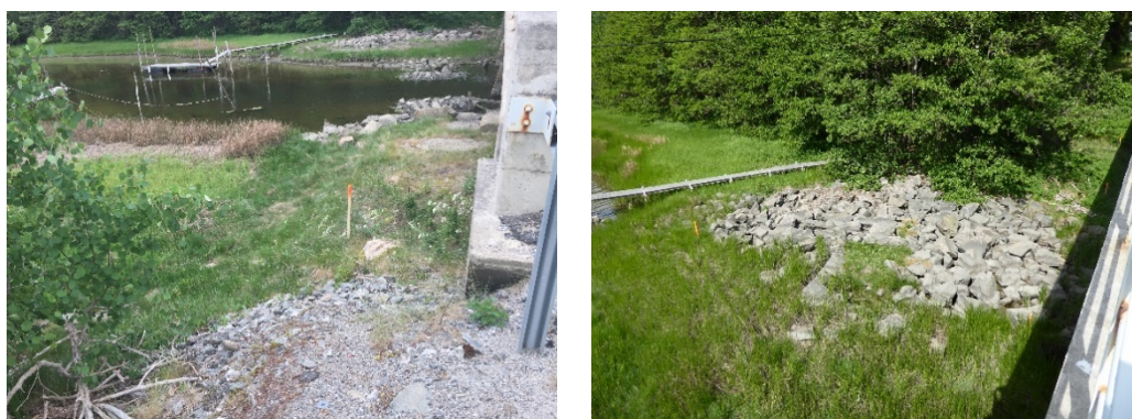
Figur 3-2: Bilder av fyllinger i ytterste del av naturreservatet inn mot dagens bru. Bildet til venstre viser fastlands-siden, bildet til høyre Grimsøy.
