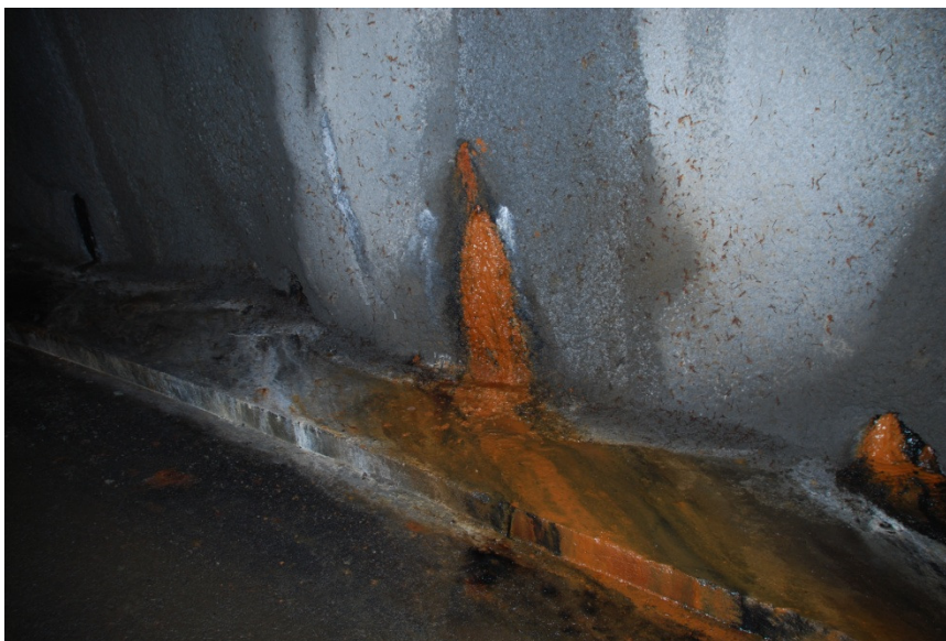
Figur 5. Foto av de oransje utfellingene inne i tunnelpassasjen.
