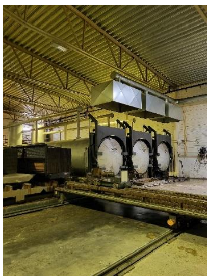
Figur 7. Helautomatisk, lukket impregnerings- og royalanlegg i bygg 115. Øverst til venstre: Både autoklave og avrenningsramper kan tippes. Nederst til venstre: Royalanlegget består av 3 autoklaver og flere avrenningsramper. Øverst til høyre: Lagertanker i Royalanlegget står i egen gruve.
