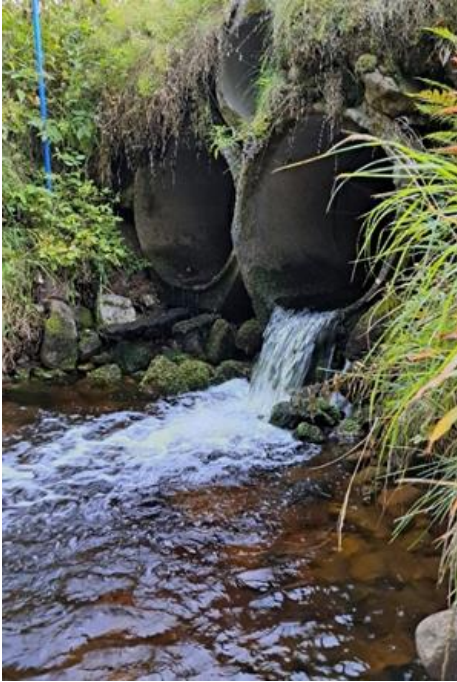
Bilde 28: Kulvert med høyt fall (trolig vandringsbarriere).
