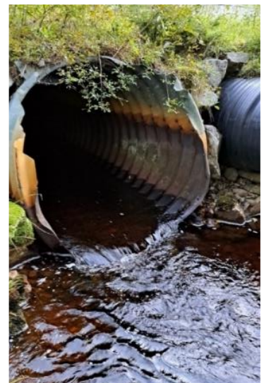
Bilde 30: Kulvert under fylkesvei 2158 i Skinnaråa. Foto: Mikael Jørgensen
