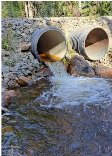
Bilde 38: Kulvert (vandringshinder) under fylkesvei 2156. Foto: Mikael Jørgensen
