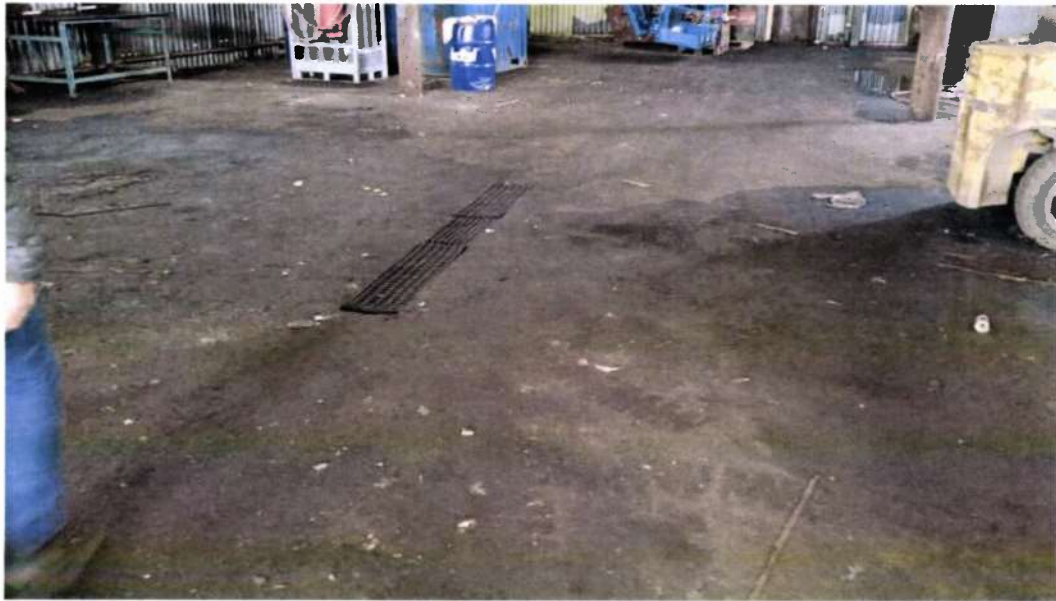
Rist inne i verkstedhall som drenerer til oljeutskiller
