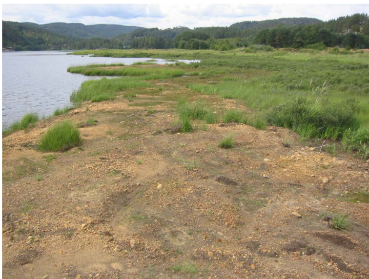
Lokalitet 2: Mannflåvann – øst Tiltak: Opprensning av krypsiv og mudder med gravemaskin langs bredden + et gruntvannsområde sør for Småøyane.
