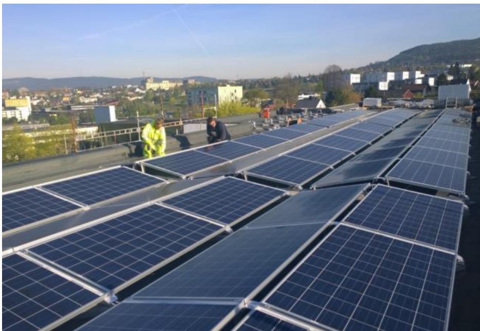
Figur 16. Solcelleanlegg på flatt tak øst/vest, Økern sykehjem, Oslo. Kilde: Thor Christian Tuv, FUSen AS.
