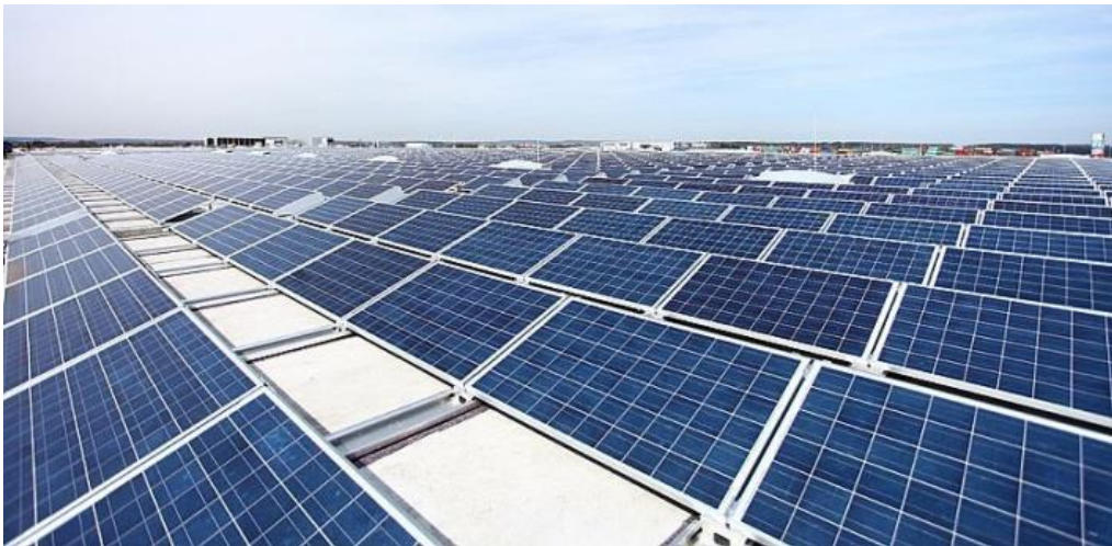
Figur 17: Solcellanlegg flatt tak sør. Kilde: Knubix/Soltop.
