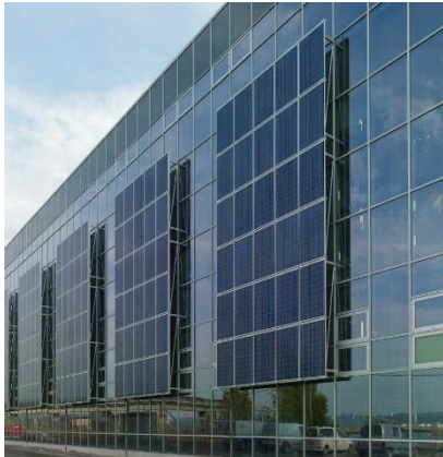
Figur 18. Eksempel solcelleanlegg fasade. RECs fabrikk Herøya. Kilde: Sapa Solar.
