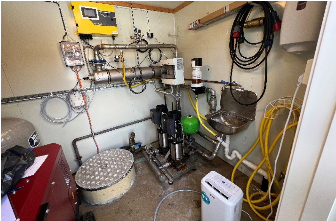
Figur 10. Bildet fra Moisund vannverk, tatt under befaring juni 2023.
