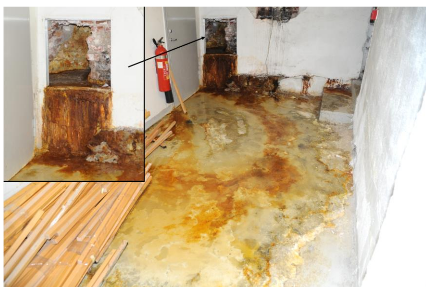
Figur 3 Innlekkasje av aggressivt vann (pH < 3) i et kjellerrom. Kontakt med vannet kan medføre fare for etseskader på huden. For vannkjemi, se Vedlegg C, Tabell C3, Prøve 1.
