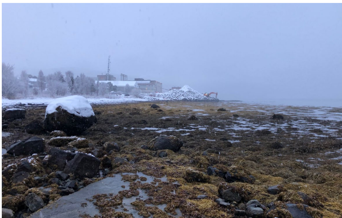
Figur 2 Bilde tatt på befaring 23.11.23. Viser pågående fyllingsarbeider ved utfylling for sørområdet til kote + 6 og TQC eksisterende industrianlegg i bakgrunnen.
