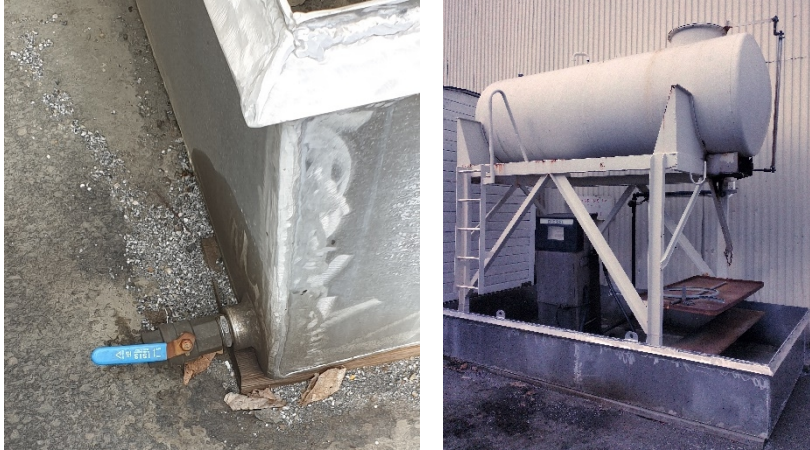
Figur 2. Oppsamlingsbasseng med åpen dreneringskran (foto: Statsforvalteren i Nordland).
