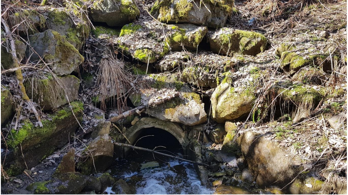
Figur 23. Innløp til Ø1000 kulvert ved planområdet. Tørrmur/stablet blokker rundt innløp.
