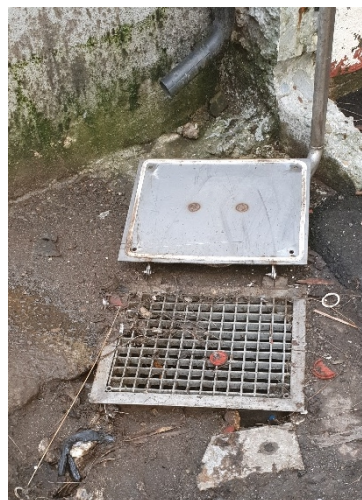
Figur 1. Rist over avløp for overvann. Foto: Statsforvalteren i Nordland
