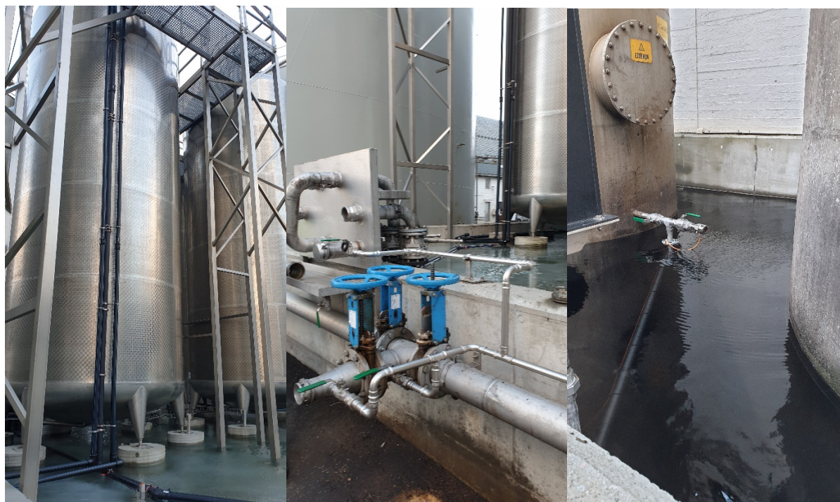
Figur 2. Oppsamlet vann i basseng rundt oljetanker (bildene til venstre og i midten) og syretanker (høyre bilde). Foto: Statsforvalteren i Nordland.
