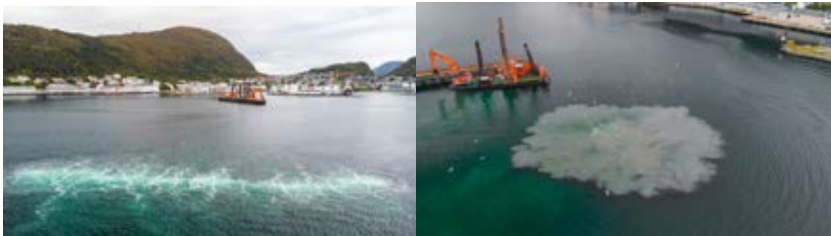
Bilder fra testinstallasjon Kystverket Ålesund – måling av funksjon og trykkdemping. Boblegardin 3,6 l/s/m
