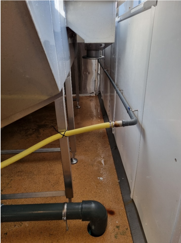
Figur 1. Nedføring av rør fra mottaksbulk uten tetning mellom rør og gulv (foto: Statsforvalteren i Nordland).
