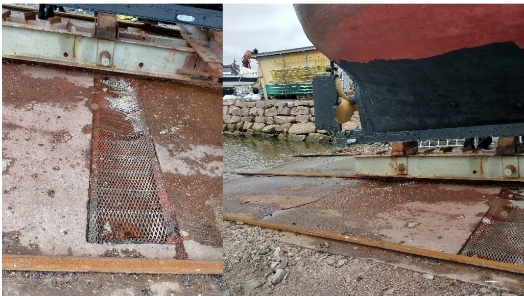
Figur 1. Venstre bilde: oppsamlingsrenna i slippen. Høyre bilde: båt som er plassert delvis nedenfor oppsamlingsrenna (foto: Statsforvalteren i Nordland).
