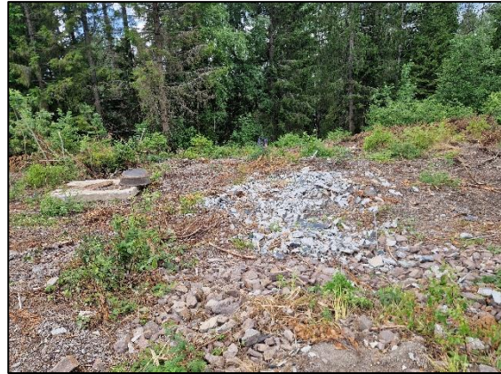
Figur 67: Aktiv rydding av gammel betong lagret ved P1 levert til egnet mottak. Bilde tatt 21.06.2023
