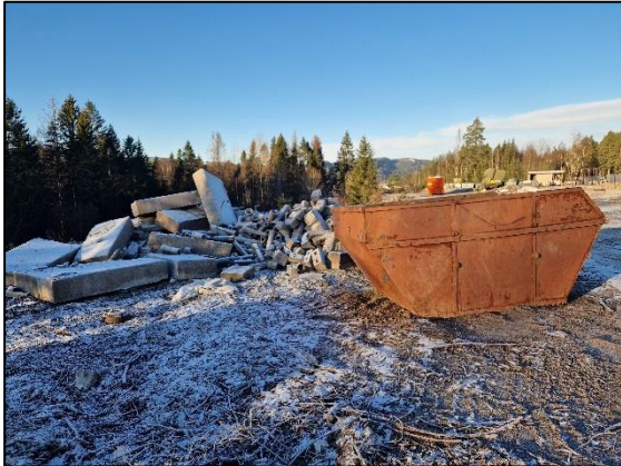
Figur 53: Området ved PK-15 med makroavfall av betong og metall i des 2022. Rød kontainer klar for fylling av avfall
