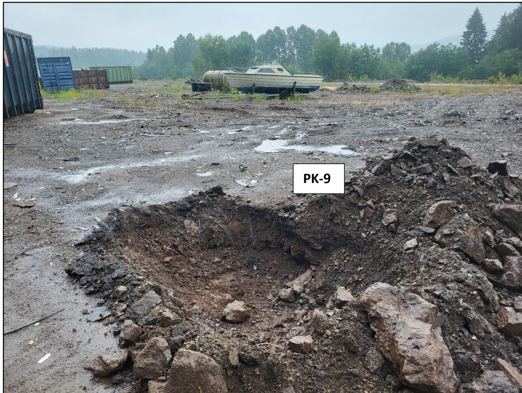
Figur 35: Eksponerte masser ned til fjell i PK-9. Mørk masse i avrettingen inneholder freseasfalt og oljestoffer. Avfall som plast, metall, bildeler etc ligger i avrettingsmassen og toppen av jorden.
