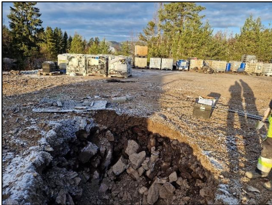
Figur 20: Betongplaten i nordøst med IBC-tanker av plast med lagret olje o.l
