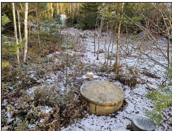
Figur 28: Oljetanker/utskillere knyttet til saneringsplattformen av betong (på nordsiden)
