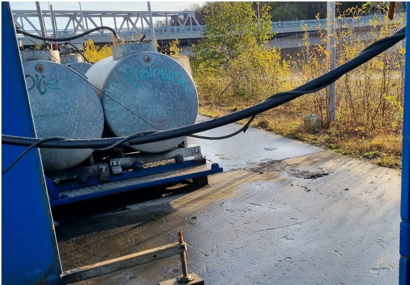
Figur 1. Tanker med flytende farlig avfall lagret utendørs og uten arrangement for oppsamling av eventuell avrenning.
