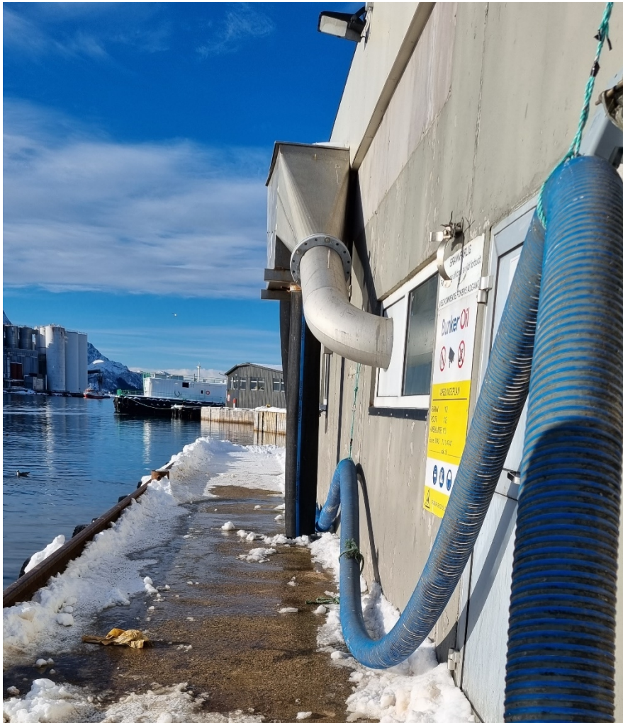
Fig. 1: Mottaksanlegg på kai hvor vann fra båtene føres ned på kaia (foto: Statsforvalteren i Nordland)
